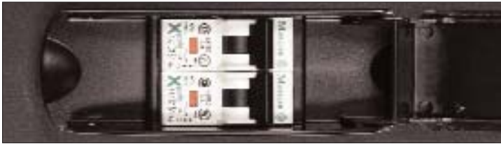
Disjoncteur hydraulique/magnétique UL 489 sur une PDU de 30 A
